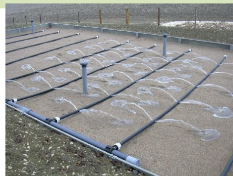
Alimentation du Filtre a sable
